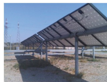
Figure 6: Photographie d'illustration de tables de modules photovoltaïques de type "trackers" (source : Étude d'impact, p. 284)
