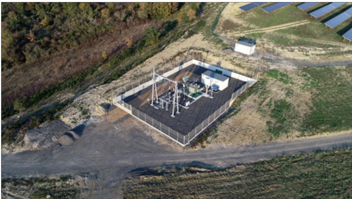
Exemple de sous-station électrique (page 36 du fichier informatique étude d'impact T2/P1)
